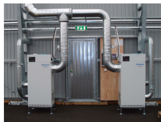
Avfuktningssystemet håller hallen och dess innehåll behagligt torr.
